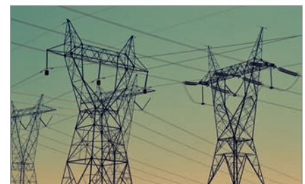
La torre de alta tensión se hace con triángulos metálicos para que sea ligera e indeformable.
