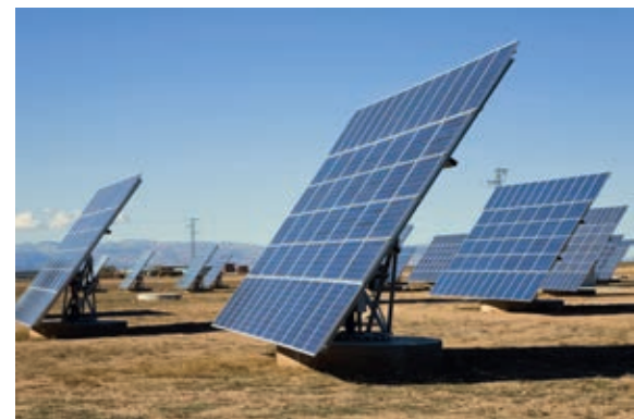
Placas solares en Guadix (Granada). La energía solar supuso el 17% de la generación de energía de España en 2024.
